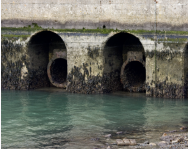
Seawater, Rainwater pipeline ท่อทะเล, ท่อน้ำฝน
